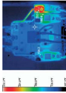
Fallo en una conexión
