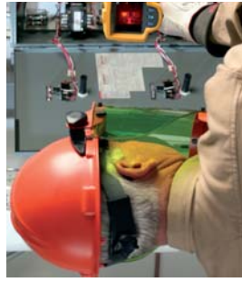
Inspección termográfica de un cuadro eléctrico
